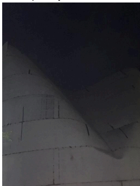
Figura 20. Vista da avaria causada no período noturno de 07/10/2025 durante ação atípica do vento.
