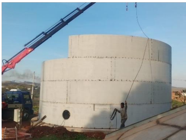
Figura 12. Vista do início da montagem da 4ª virola do costado do reservatório.
