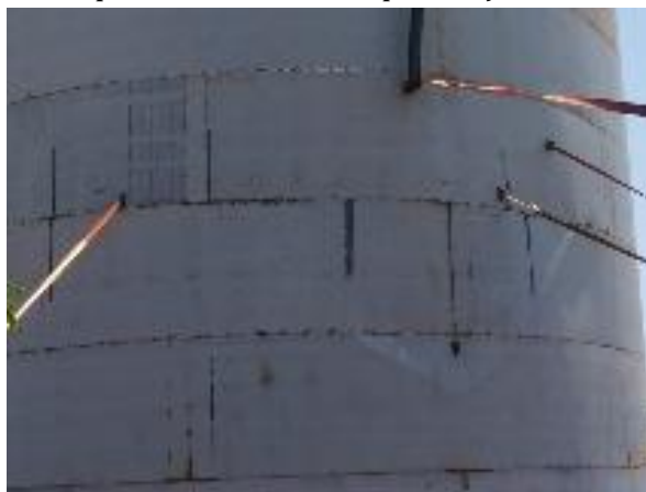
Figura 35. Vista da única chapa danificada a qual será substituída posterior ao processo de industrialização e tratamento de superfície da nova chapa de aço A-36.
