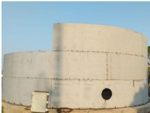
Figura 11. Vista do início da montagem da 3ª virola do costado do reservatório.
