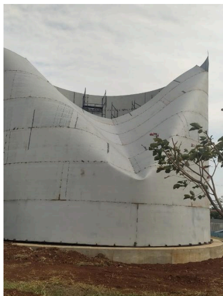
Figura 22. Vista da avaria causada no costado do reservatório devido a ação do vento.
