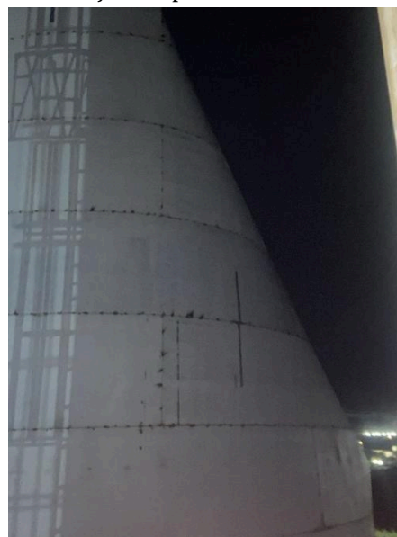
Figura 21. Vista da avaria causada no período noturno de 07/10/2025 durante ação atípica do vento.
