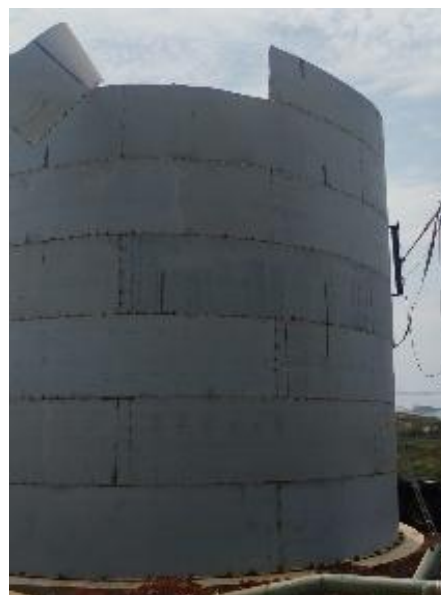
Figura 23. Vista da avaria causada no costado do reservatório devido a ação do vento.
