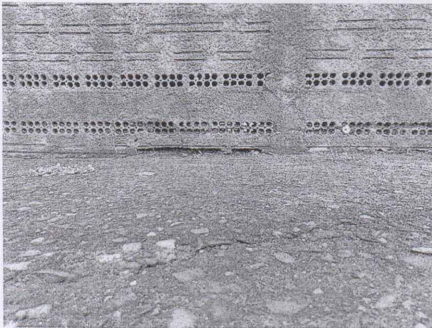
FOTO 3: PONTOS ONDE OS TIJOLOS DA BASE RUIRAM, AREA EXTERNA DO LOTE.
