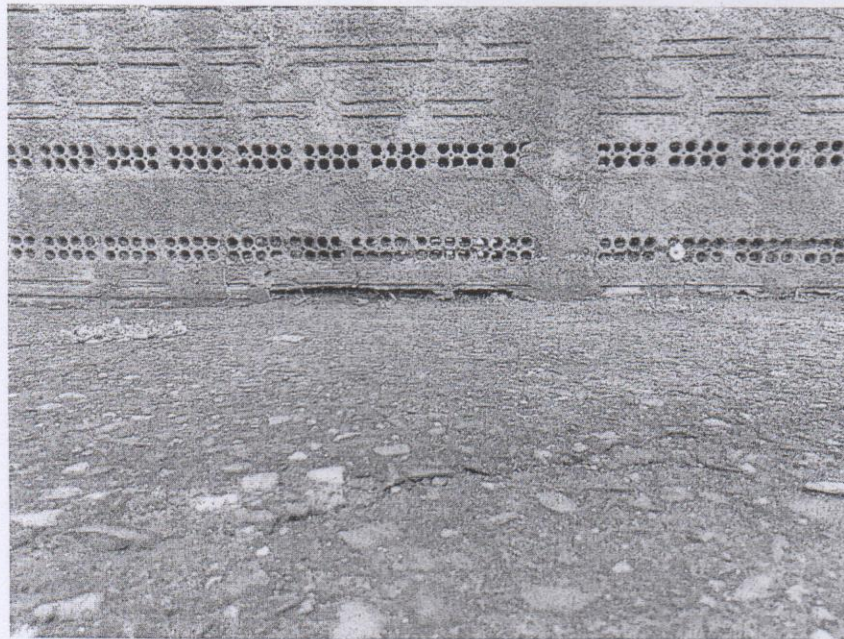
FOTO 3: PONTOS ONDE OS TIJOLOS DA BASE RUIRAM, AREA EXTERNA DO LOTE.
